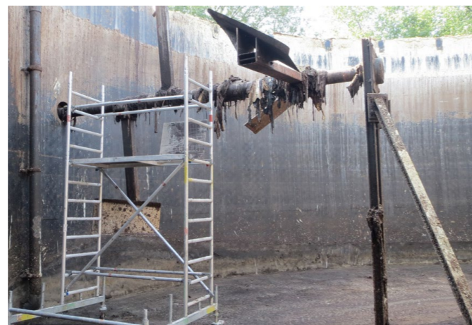
Paddelrührwerk in einem geleerten Fermenter
