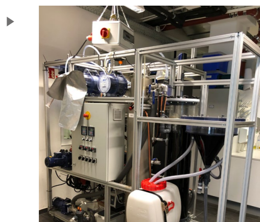
1 x 175 Liter, dreistufige Abwasserbehandlungsanlage mit anaeroben Belebungsverfahren (CSTR, Sedimentationsbecken), Hochlastreaktor (EGSB) und aeroben Belebungsverfahren (Belüfteter Reaktor, Sedimentationsbecken)
