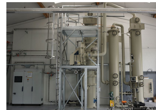
Strippanlage in der Versuchshalle am FH-Standort in Bioenergiepark Saerbeck
