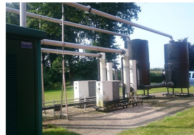
Gasreinigung einer Biogasanlage
