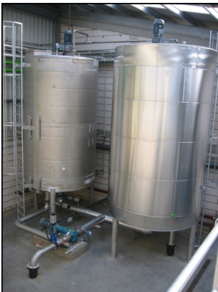
Bild 2: Hygienisierbehälter (links) und Abkühlbehälter (rechts)
