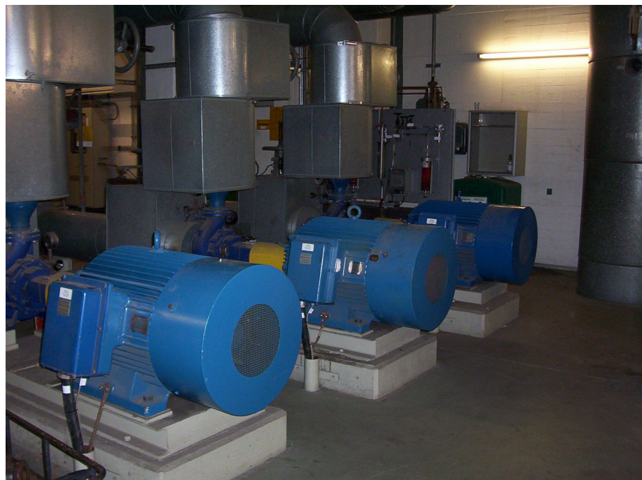
Pumpstation einer Fernwärmeerzeugungseinheit
