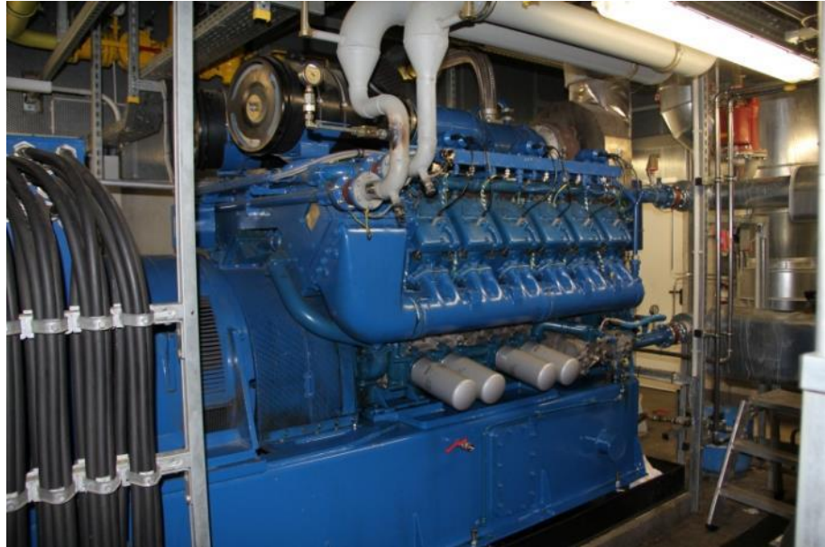
Abbildung2: BHKW zur Wärmeversorgung der Turbine
