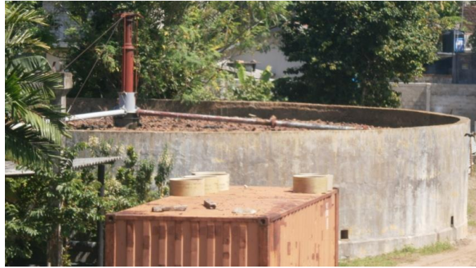
Abbildung 2: Tropfkörper in der Abwasserbehandlungsanlage in Soysapura
