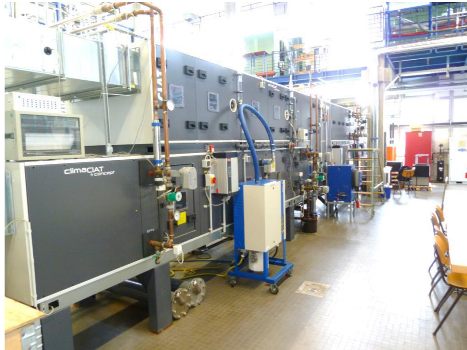
Klimaversuchsanlage des Labors für Raumluftechnik
