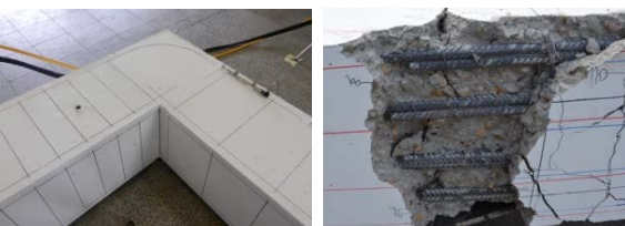
Ansicht einer Rahmenecke und freiliegende Bewehrung nach der Belastung
